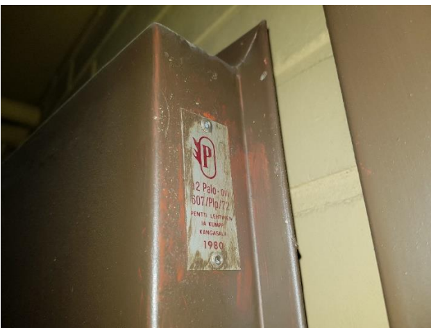
Kuva 11. Palo-ovet todennäköisesti asbestipitoisia.
